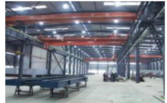
Pont roulant électrique
